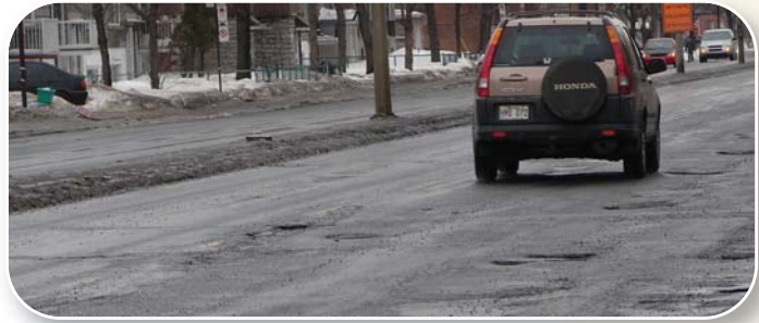
Début de dégradation majeure de la chaussée
