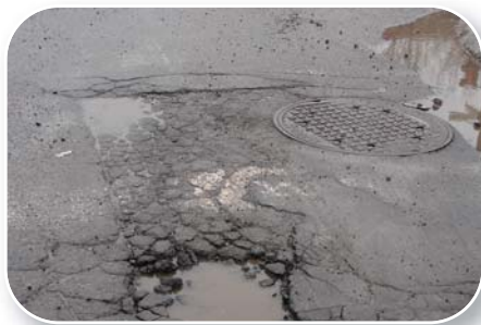
Gonflement des chaussées par l'eau de fonte
