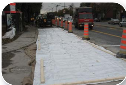
Toiles de jute et signalisation
