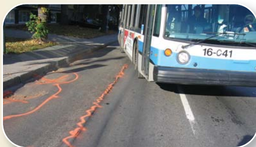
Détérioration de la chaussée
